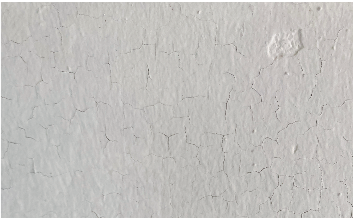
Spannungsrisse ermöglichen das Eindringen von Feuchtigkeit in den Untergrund.
