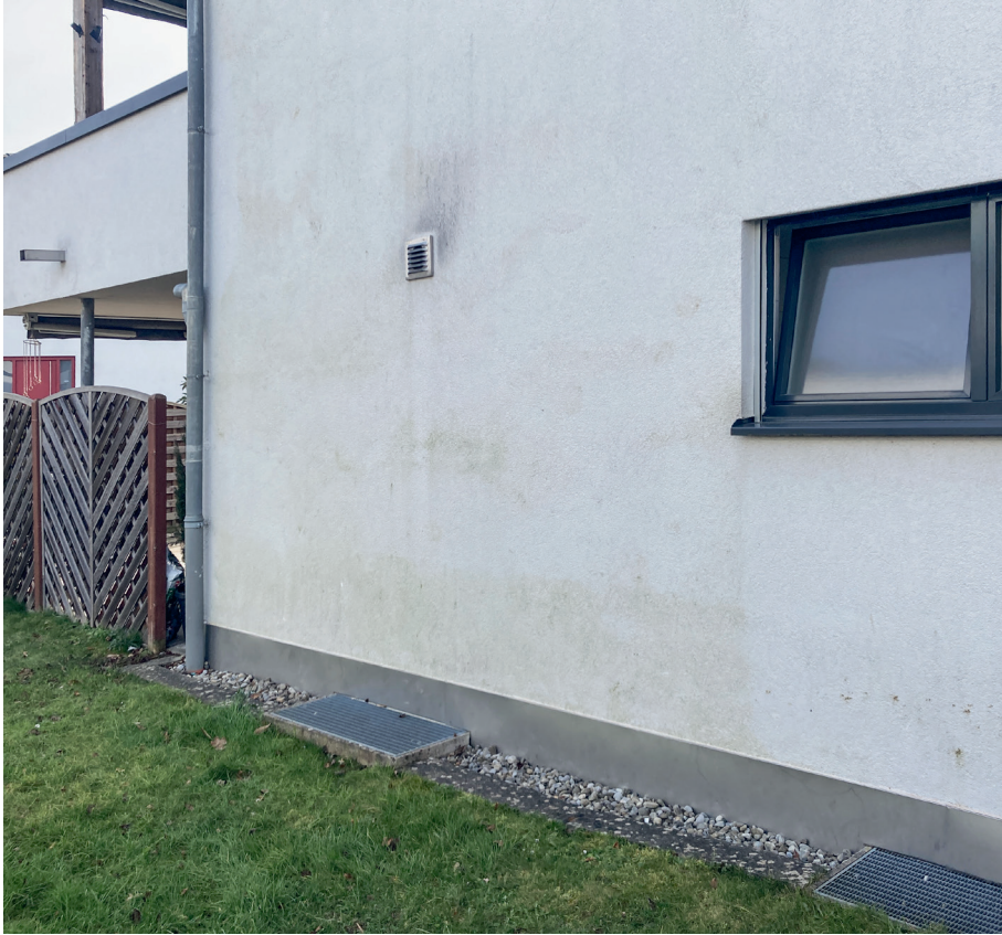
Moos- und Algenbildung an der feuchtigkeitsbelasteten Nordseite des Gebäudes.
