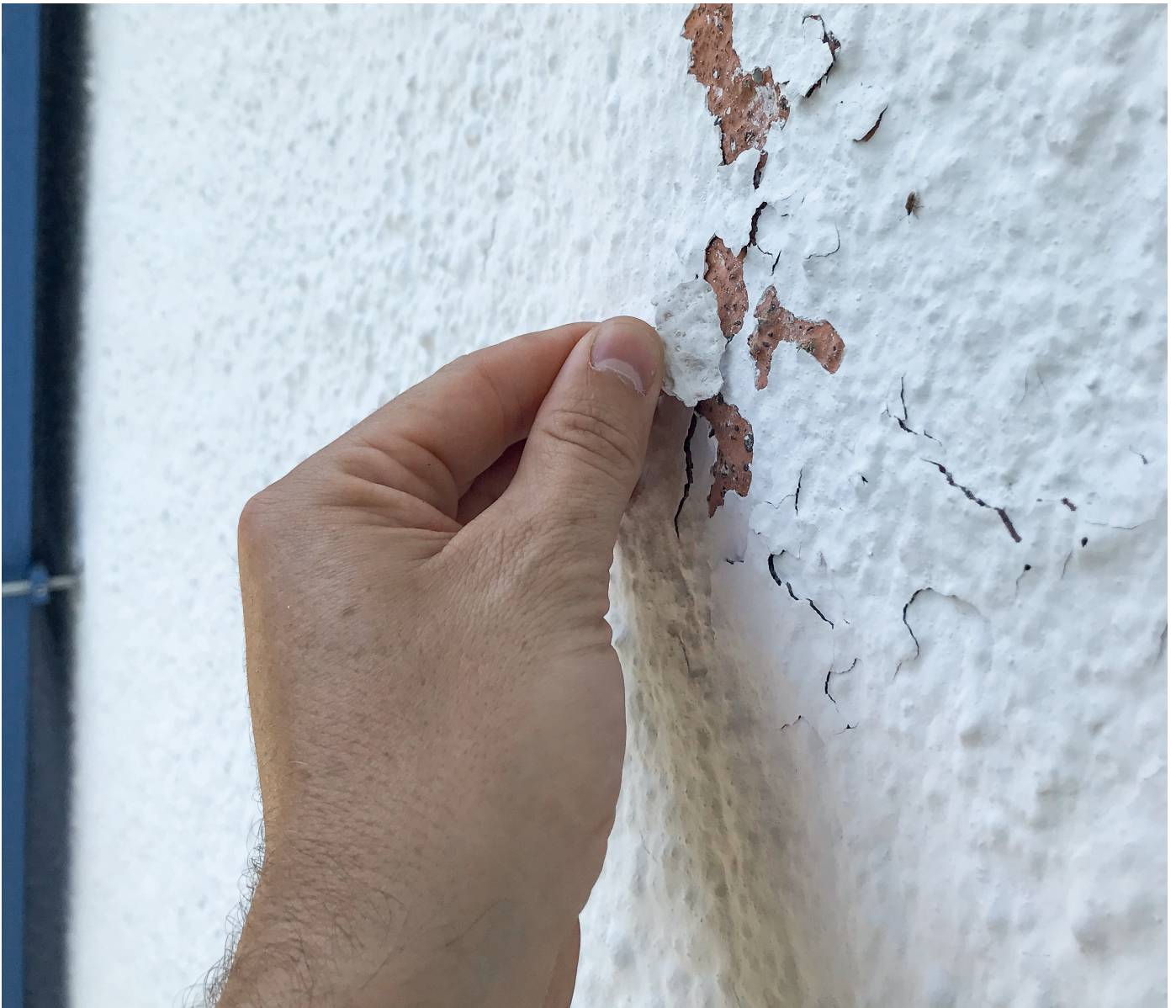
Abplatzungen der Deckschicht infolge unterschiedlicher bauphysikalischer Eigenschaften.
