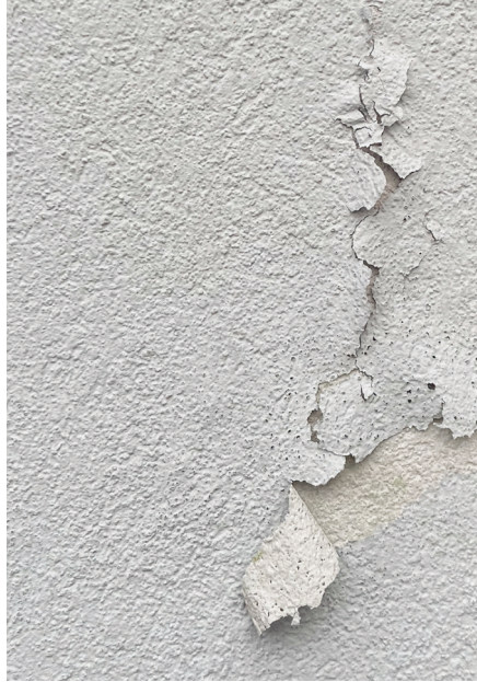
Abplatzungen der Deckschicht infolge unterschiedlicher bauphysikalischer Eigenschaften.
